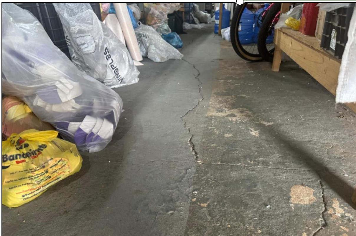
Rachadura no piso de concreto
