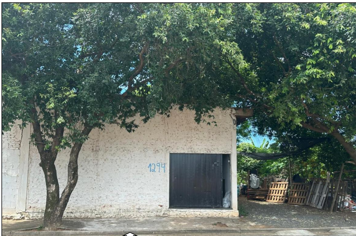
Acabamento externo deteriorado
