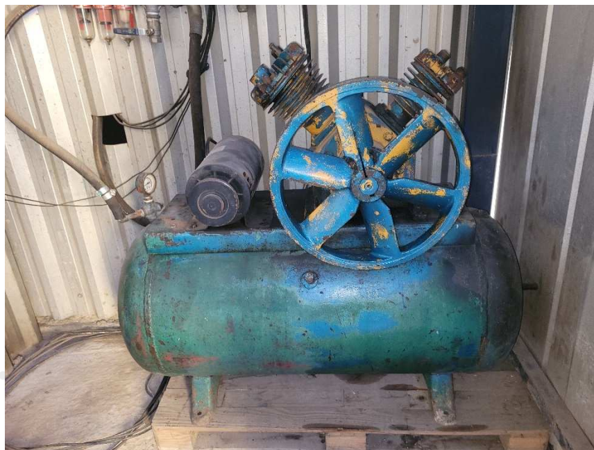
COMPRESSOR DE AR
