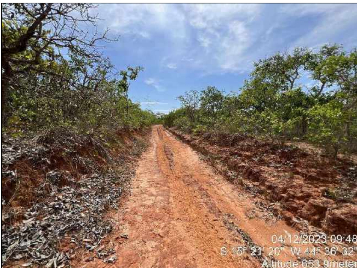
Foto 33 – Estradas internas sem sinais de transitabilidade.
